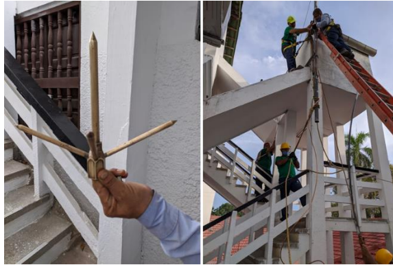
Ilustración 19. Sistema de apantallamiento en cubierta. Fuente: Informes de obra
